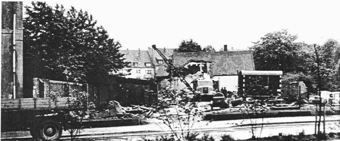
Blick von der Alfredstraße auf den abgerissenen Lagerplatz der Firma Schremmer
